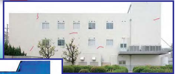
可視画像(目視検査によるクラック確認)
